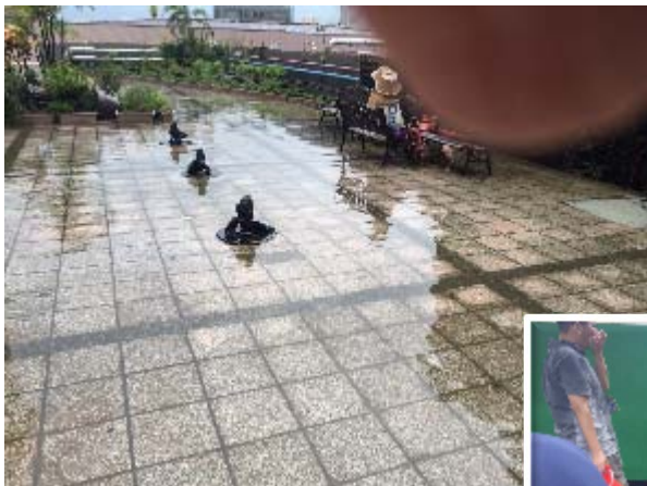
頂樓淹水 ↑ 沿著樓梯流到B1→
