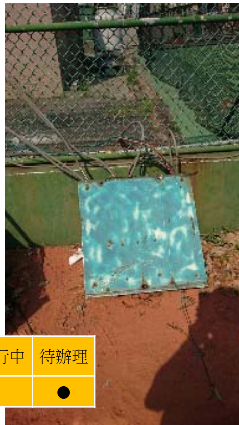
自由路排球場 配電盤故障→
